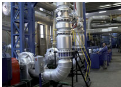
Heizungs- und Klimatechnik
